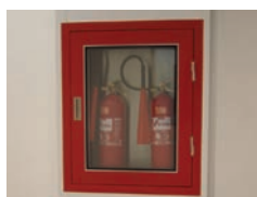
Caixa de hidrantes e extintores
